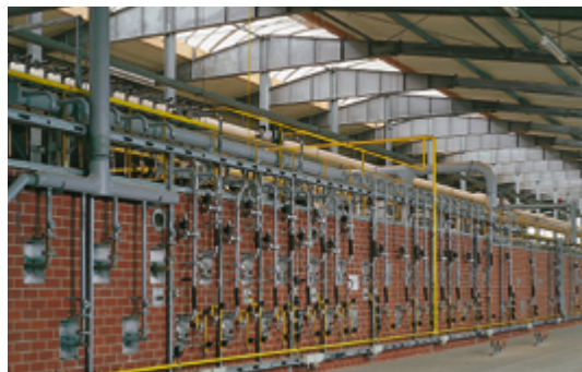
Armatury Elster Kromschroeder w przemyśle ceramicznym
