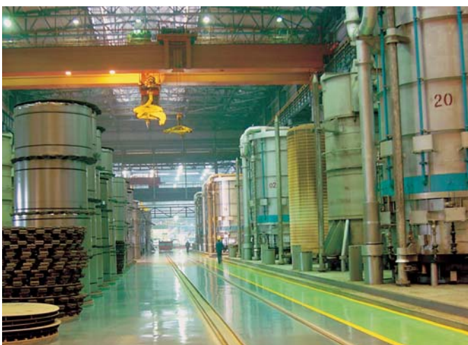
Bild 7: Haubenglühanlage (Firma LOI) Fig. 7: LOI bell-type annealing installation
