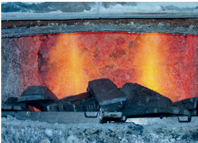
Bild 3: Aluminiumschmelzofen im Volllastbetrieb. Der Ofen ist bestückt mit Aluminiummasseln. Betrieben durch zwei ZIO 165 Elster Kromschroder Brenner, Nennleistung je Brenner 630 kW
