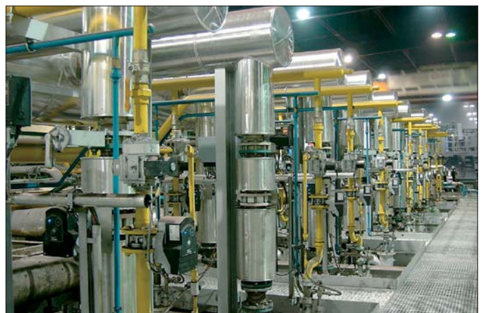
Bild 8: Beheizungseinrichtung der Deckenbrenner Fig. 8: Control system of the roof burners
