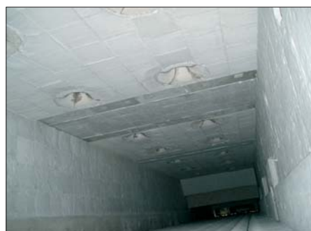
Bild 1: Hubherdofen mit trompetenförmigen Brennersteinen in der Decke
