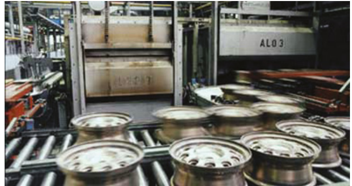
Horno de endurecimiento de aluminio con reguladores de proporción para protección de la falta de aire
