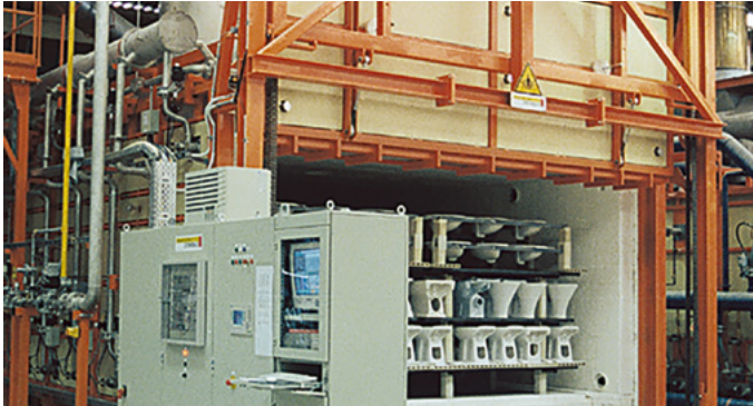
Regulador de presión en quemadores con exceso de aire en la industria cerámica
