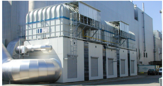
Installation de postcombustion pour l'épuration thermique régénérative de l'air d'échappement
