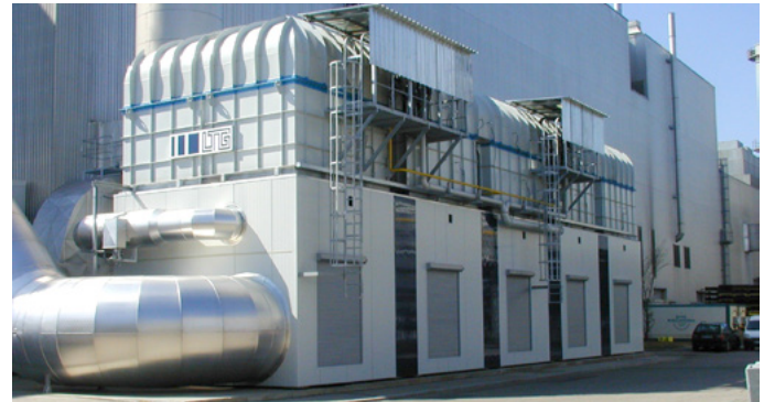
Nachverbrennungsanlage für thermisch-regenerative Abluftreinigung
