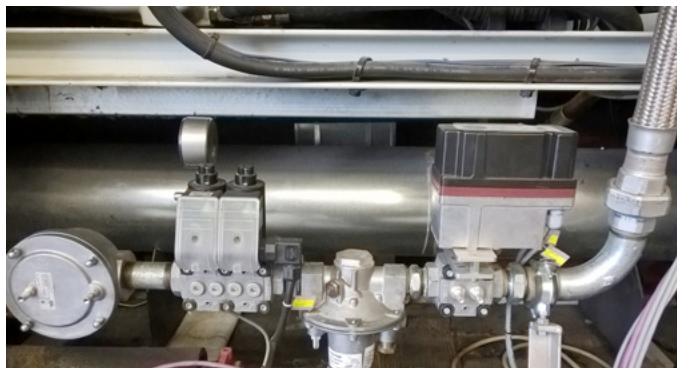
Centrale de cogénération pour la production d'électricité et de chaleur
