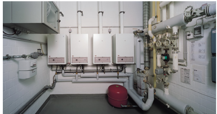
Druckwächter DL sichert jeden Abgasweg in der Kaskade ab
