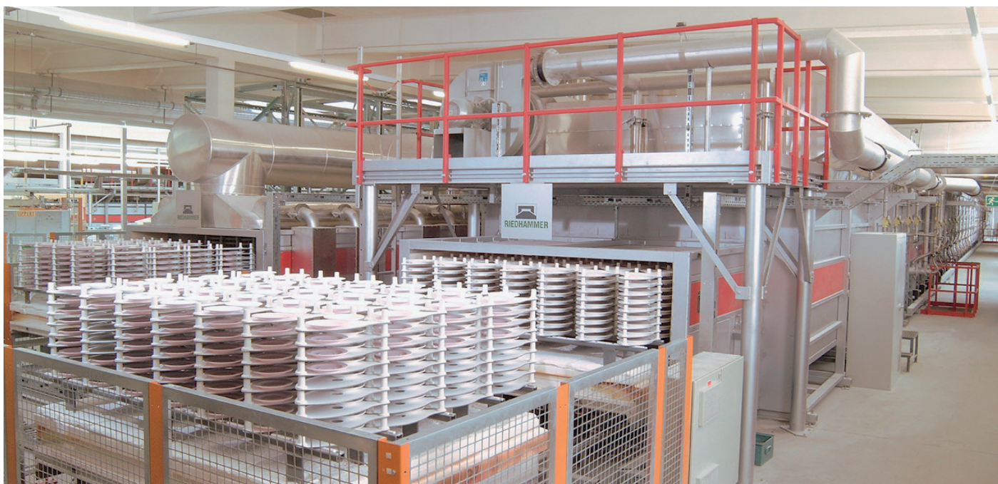
Tunnelofen, Werksfoto Riedhammer
