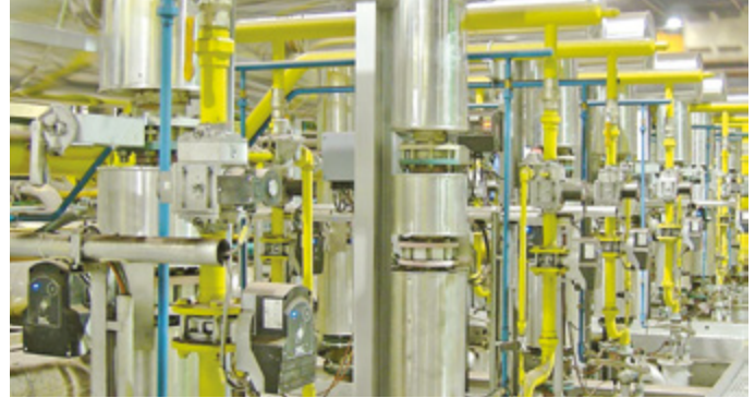
Hubbalkenofen mit Deckenbeheizung
