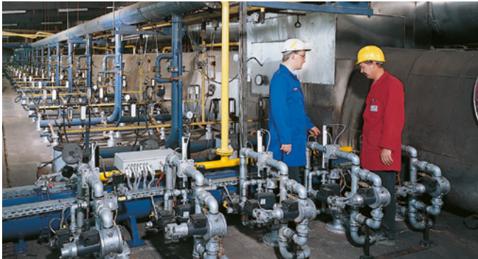
Ligne gaz dans une briqueterie
