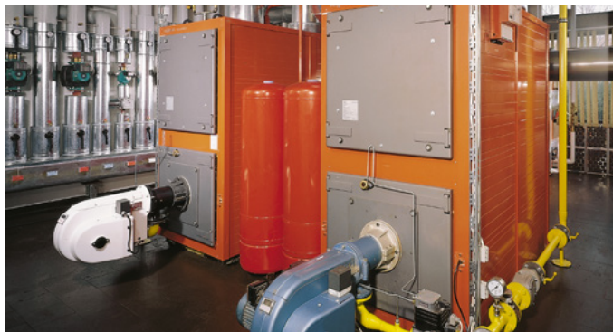
Contrôle de la pression amont gaz sur les chaudières de puissance élevée
