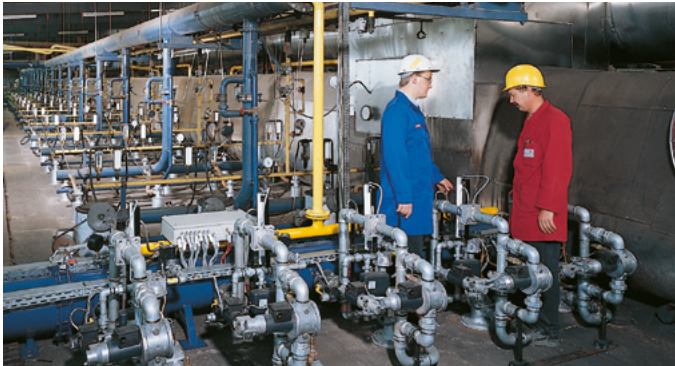
Gasstraße in einer Ziegelei
