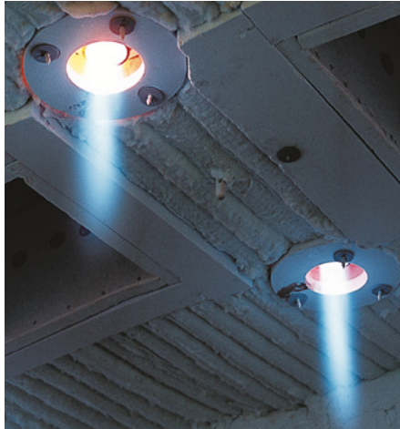
Deckenbeheizung mit Brenner BIC
