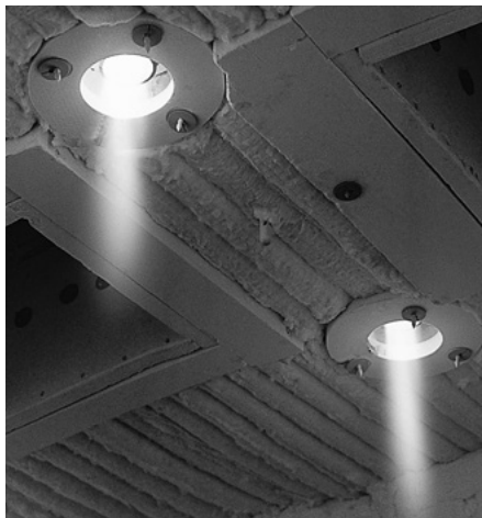
Combustion en voûte avec le brûleur BIC
