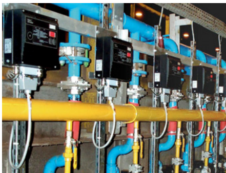
Four de trempe équipé de nom- breux brûleurs industriels en ligne
