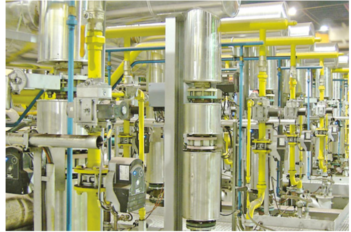
Hubbalkenofen mit Deckenbeheizung
