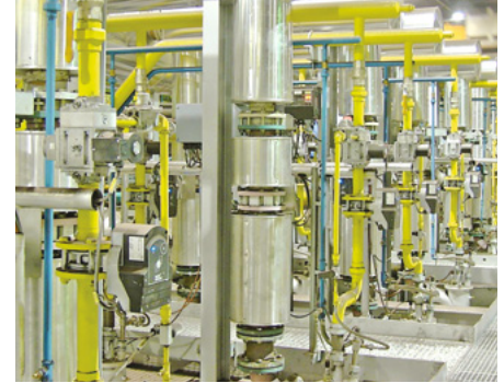
Hubbalkenofen mit Deckenbeheizung
