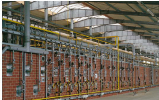
Vannes Elster Kromschroder dans l'industrie de la céramique
