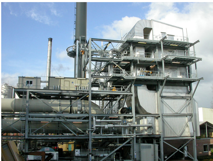
de NOx installation
