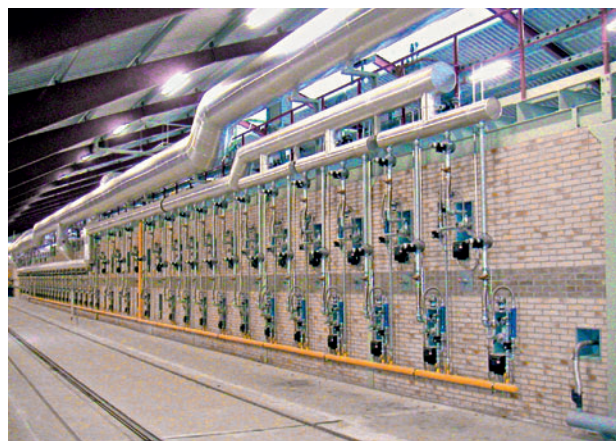
»3 Classic tunnel kiln in the brick industry »3 Klassischer Tunnelofen der Ziegelindustrie
