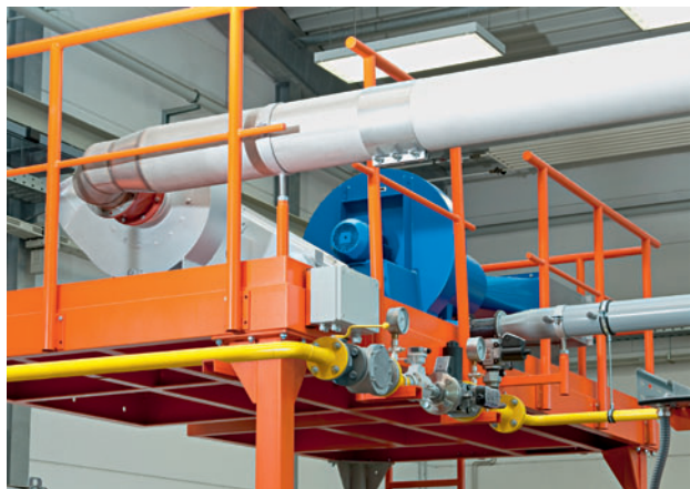
»2 Section from a gas pressure control train »2 Ausschnitt aus einer Gasdruckregelstrecke
