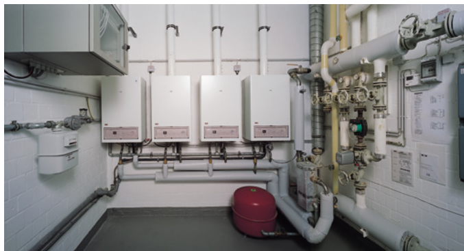
Le pressostat DL protège chaque carneau dans la cascade
